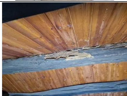
Photo n° PhTer005 Localisation : grenier Ouvrage : poutre bois Parasite : ---- Insectes à larves xylophages ----, Anobium punctatum (Petites vrillettes) Indices : altérations dans le bois
