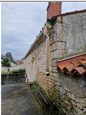
Photo n° PhTer007 Localisation : Parties extérieures Ouvrage : remplacer les gouttières (arriere murs en pierre) Informations complémentaires : risque d'humidité dans les murs de pierre
