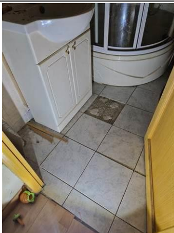
Photo n° PhTer006 Localisation : Salle de bain Ouvrage : sol carrelage abime
