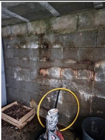
Photo n° PhTer008 Localisation : extérieur sous terrasse Ouvrage : sous terrasse Informations complémentaires : traces d'humidité important
